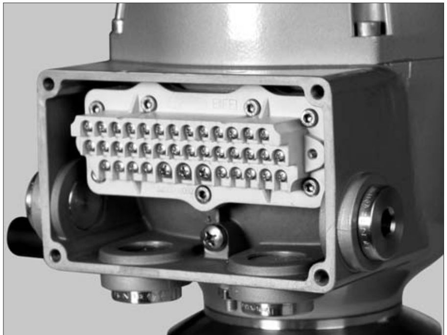
Vista geral das entradas das condutas de cabos.
